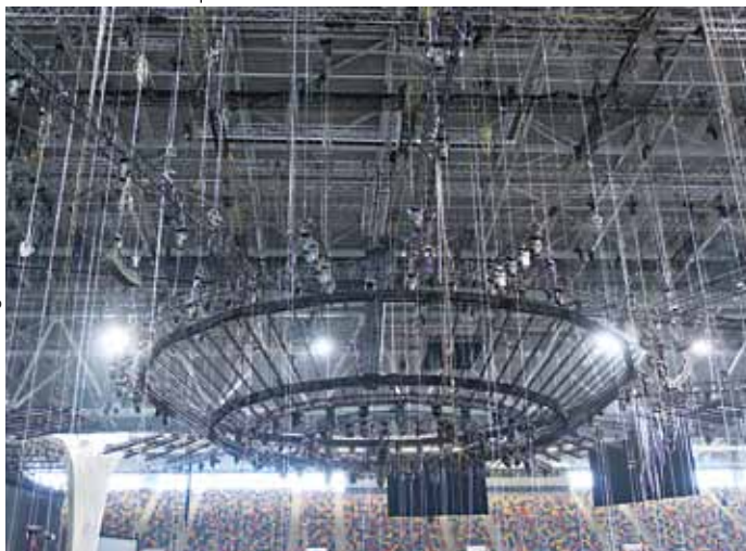
Das Bild vermittelt einen Eindruck von der Unzahl an Kettenzügen für die abgehängten und zu bewegenden Lasten
